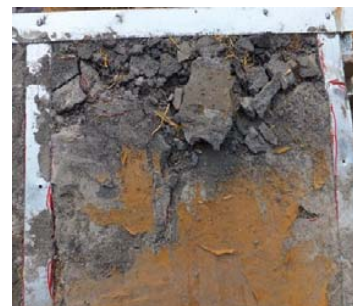
(d) Brittle failure of W-3 FC
