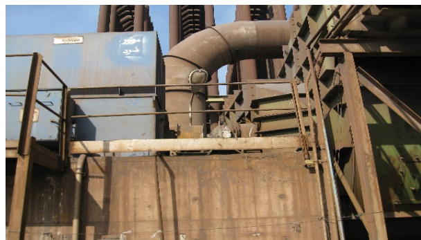
Fig. 1 Motor of fan process
