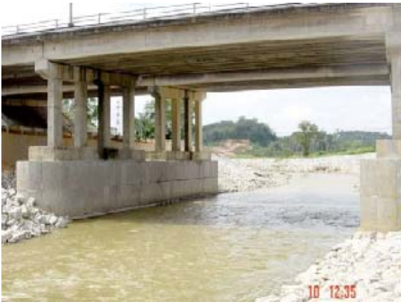
Fig. 7 Scour at Sg. Langar and Sg. Semenyih bridges
